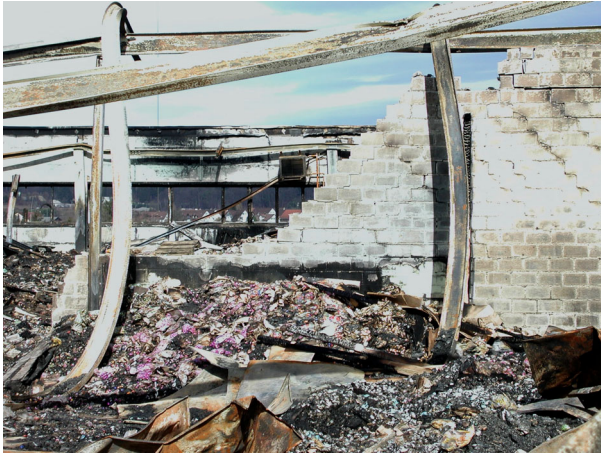
Durch Hitzeeinwirkung tordierte Stahlbauträger nach Brand, welche die brandabschnittsbildende Wand umstiess (Bildquelle: GV ZH).
